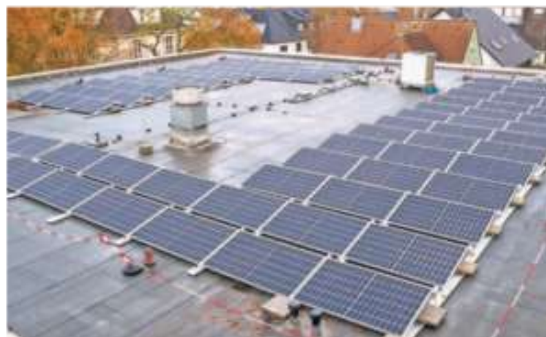
Auf dem Rathausdach Erkraths gibt es jetzt eine Photovoltaik-Anlage. Aber auch in Mettmann und Wülfrath tut sich was.
